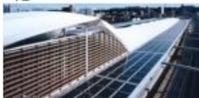
元住吉駅太陽光パネル
